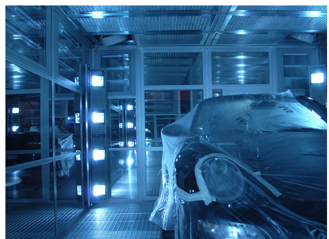
Abb. 26 Kombikabine in Spezialausführung mit UV-Strahlern
